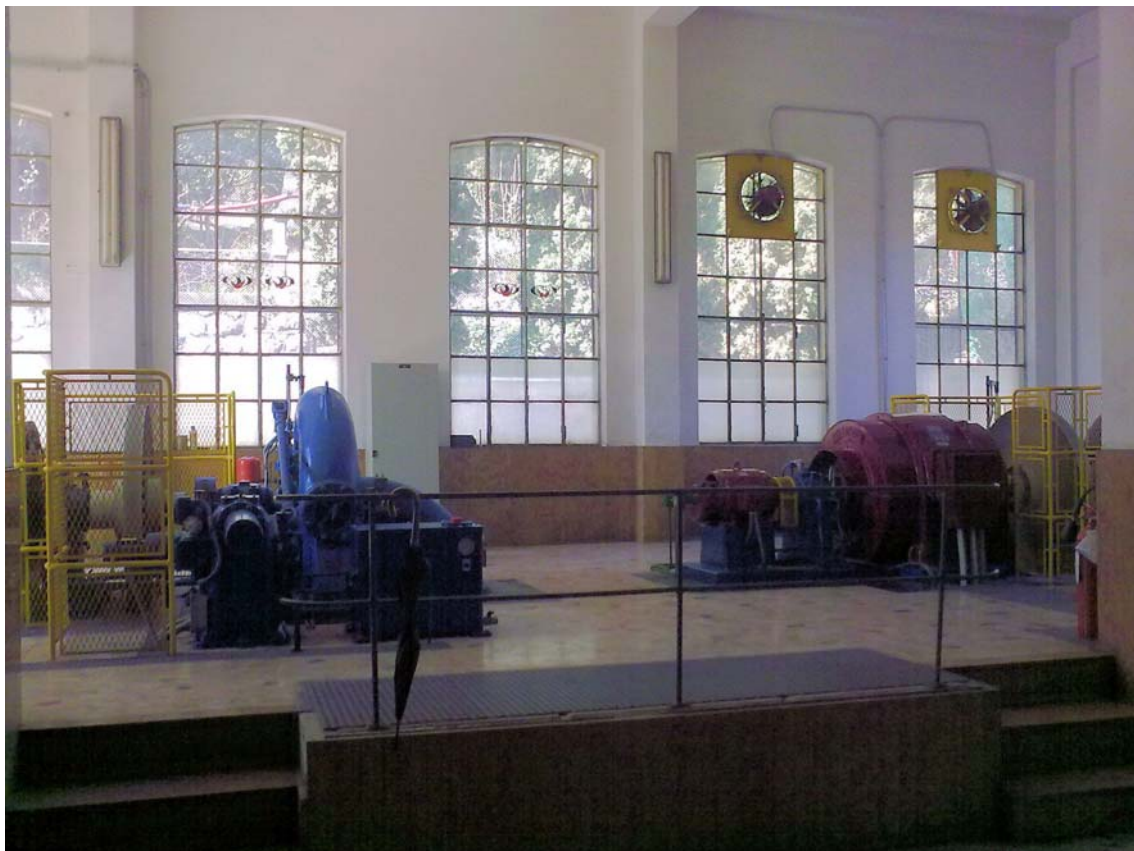
Fig. 29 –Interno della sala machine della centrale idroelettrica.
